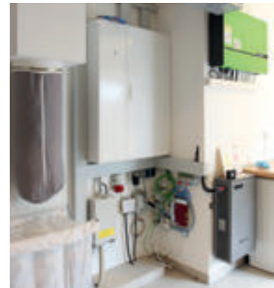
Im Haustechnikraum ist neben dem Wäscheabwurf ein Wechselrichter mit Batteriespeicher für die Photovoltaikanlage untergebracht.
